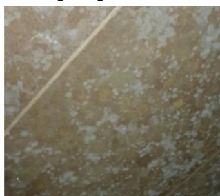
schimmel op dakplaat op zolder
